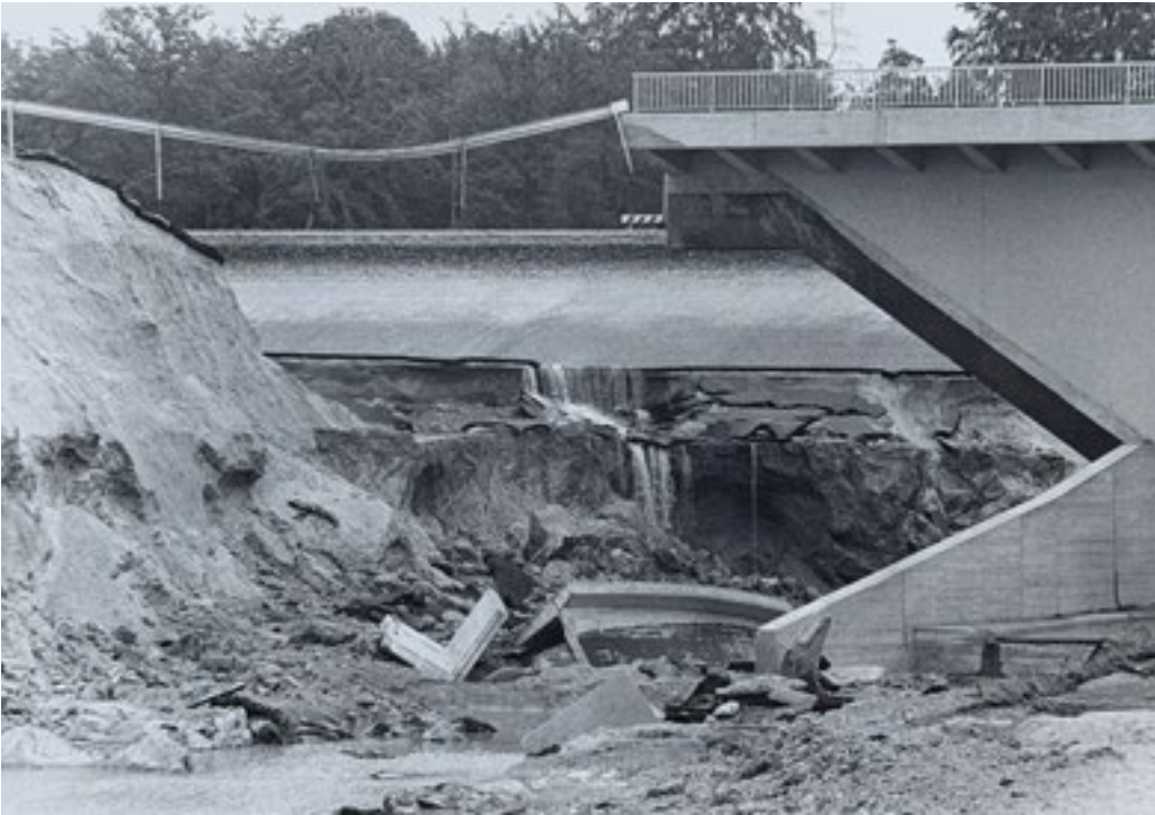
Die Bruchstelle am Nutzfelder Weg
